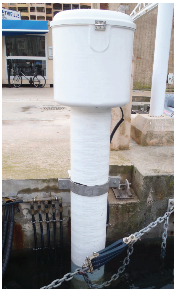
Figure 5 : Tube de tranquillisation et caisson abritant le télémètre radar.
