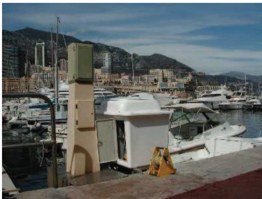
Figure 2 : Photo du caisson abritant le MCN.
