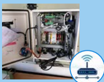
Routeur Lien réseau
